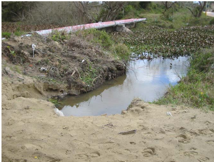
Figura 6: Drenagem inadequada para o Arroio Bolaxa, construída ao longo da RS-734.
