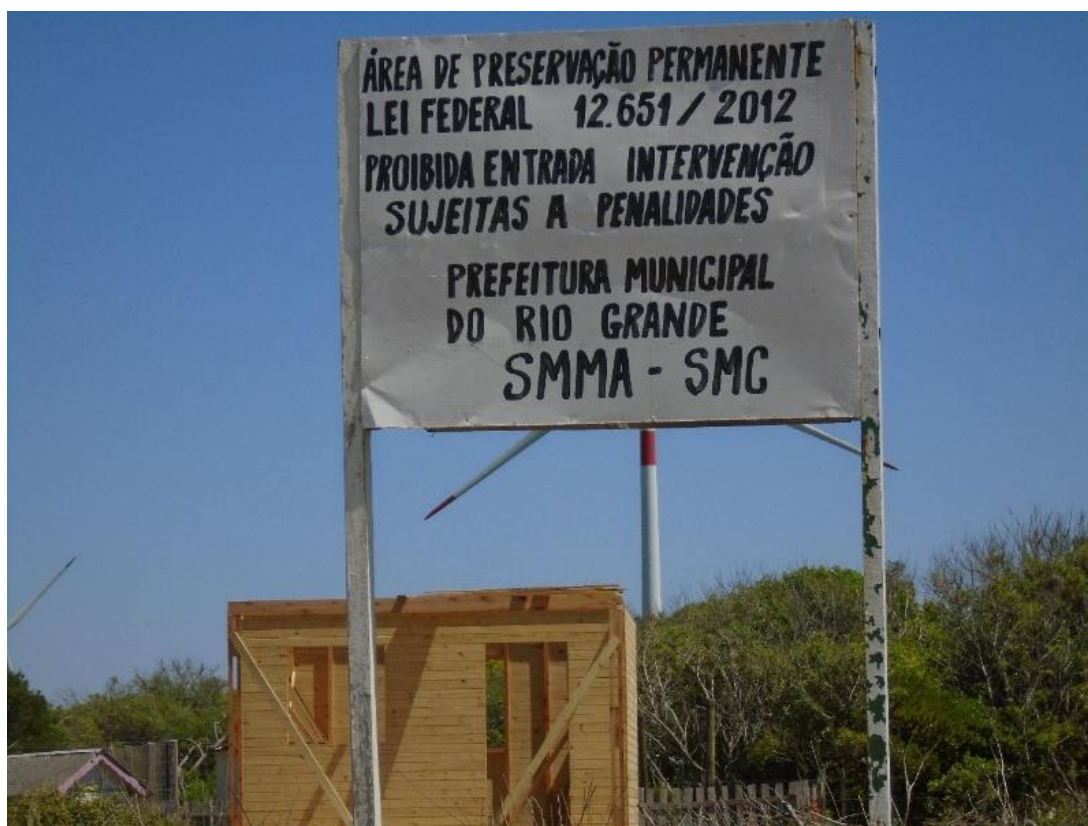
FIGURA 66. Moradia sendo construída logo atrás da placa colocada pela SMC e que adverte tratar-se de ação proibida, sujeita a penalidades.
