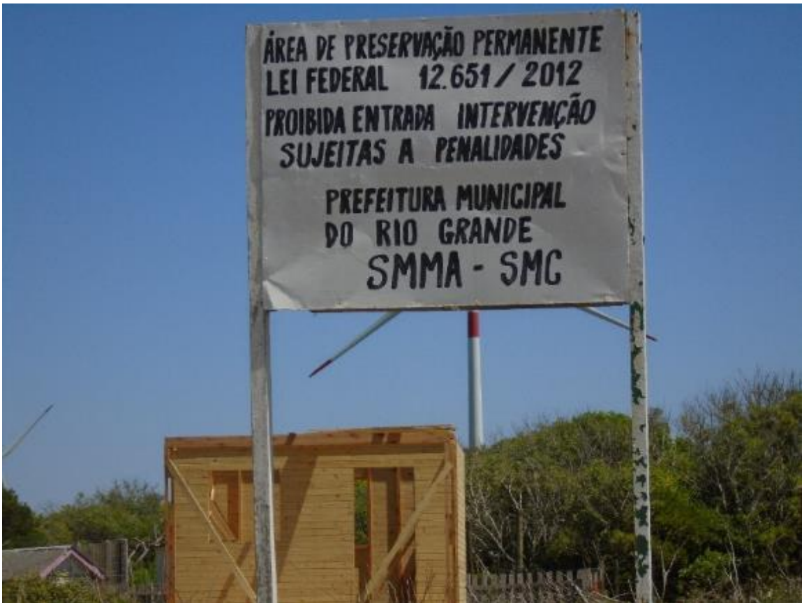
FIGURA 63. Moradia sendo construída logo atrás da placa colocada pela SMC e que adverte tratar-se de ação proibida, sujeita a penalidades.
